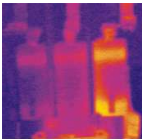
Слика 2. Термографски снимак малоуљног прекидача 20 kV [1]
