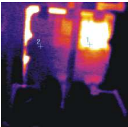
Слика 3. Термографски снимак SF 6 прекидача 20 kV [1]
