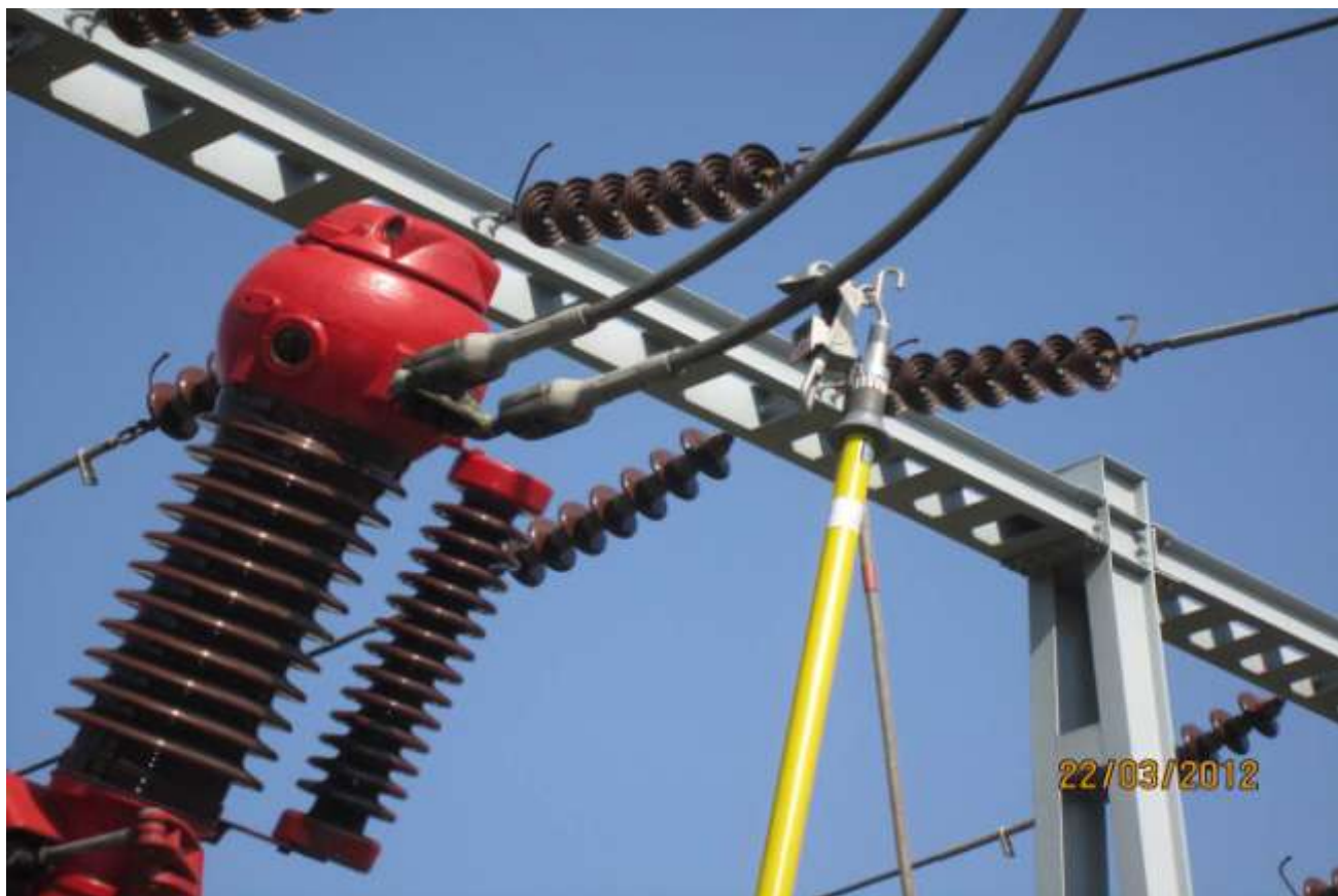
Слика 9. Постављање уземљења
